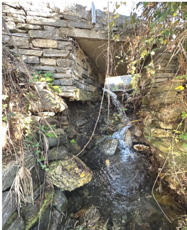
Int. B - Erosione fondo e sponde
