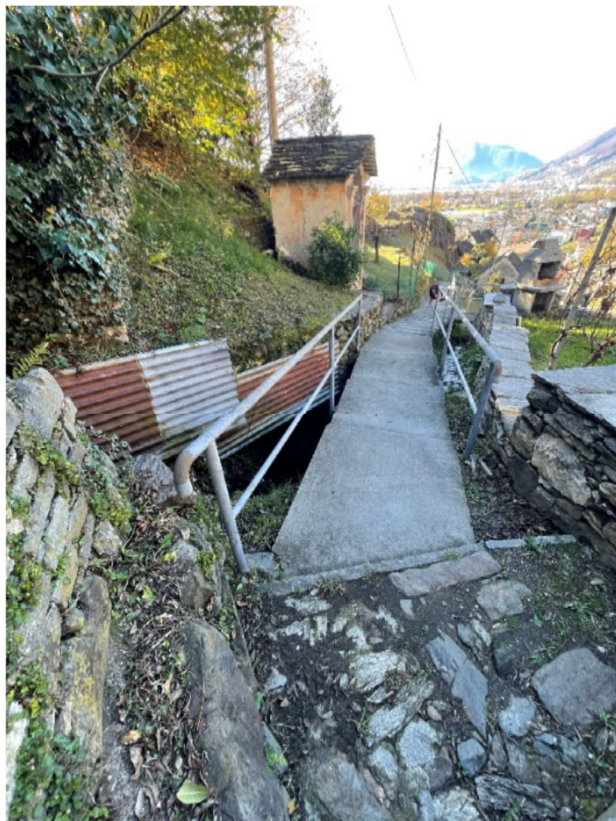
Int. D - Erosione in sponda sinistra
